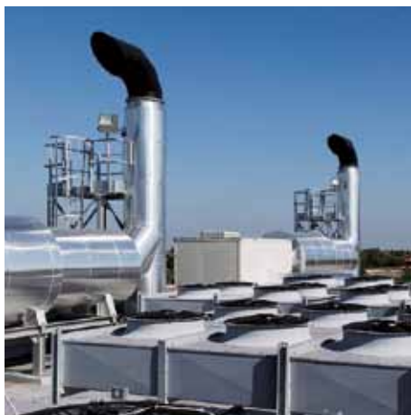
Электростанция компании Cereal Docks в г. Камизано-Вичентино. Радиаторы системы охлаждения размещены на крыше здания.
